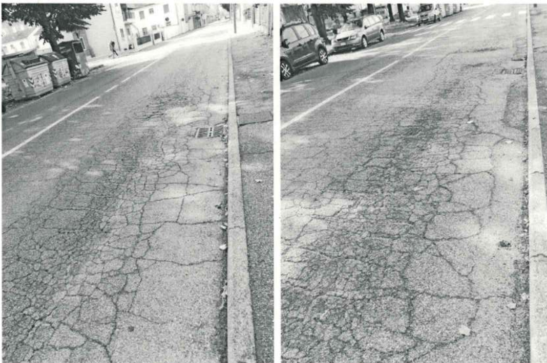
Via Braghini- stato del manto stradale e marciapiedi 12/10/18
