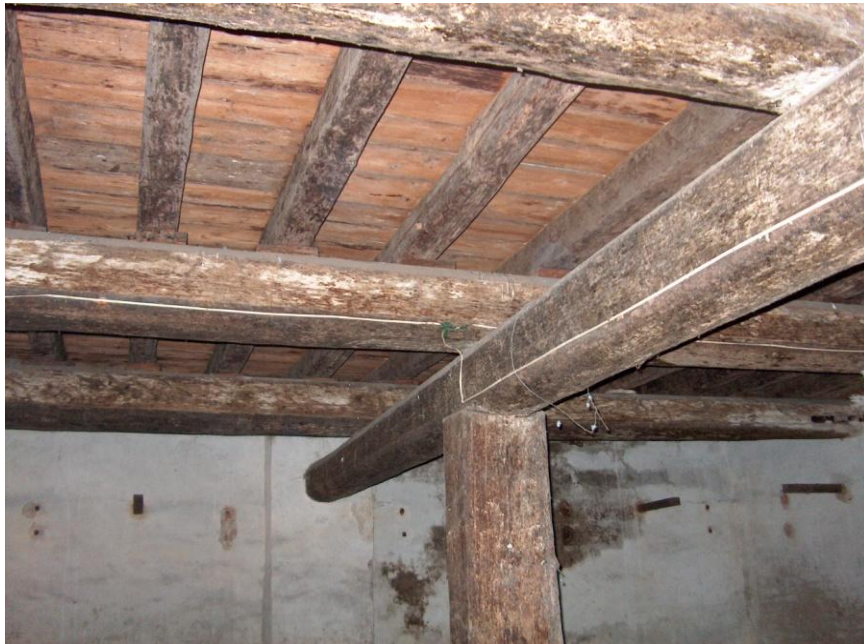
Immagine 13 e 14 Particolare solaio Stanza PTs1
