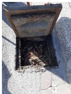
Fig. 2, 3. Caditoie ostruite in via Ribaltina
